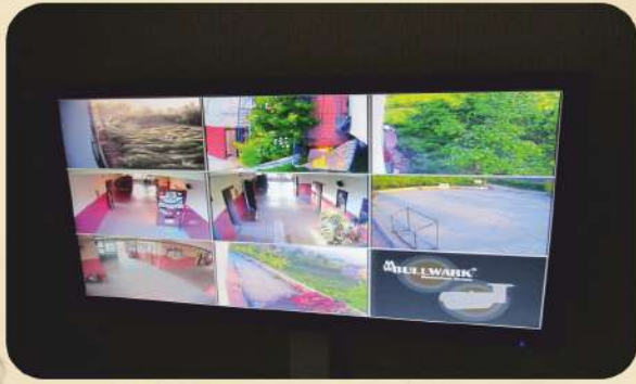
Okulumuza güvenlik kamera sistemi yapıldı
